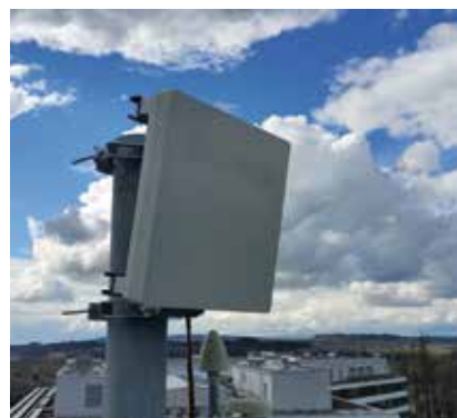
In Ittigen ist die erste 5G-Antenne bereits in Betrieb.
